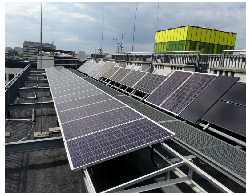
Stanowiska badawczo-dydaktyczne zlokalizowane na dachu budynku C3 Akademii Górniczo-Hutniczej
